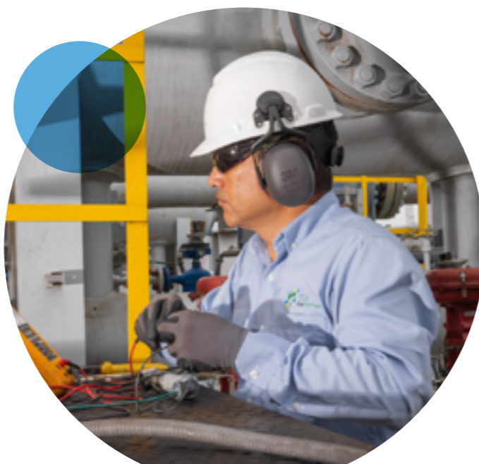
Equipo Estación de Compresión de Gas Padua
