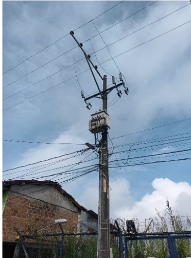
Fotografía 3-52 Energía eléctrica Municipio de Palestina
