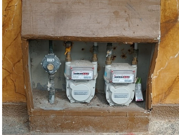
Fotografía 3-53 Contador gas domiciliario - Municipio de Palestina
