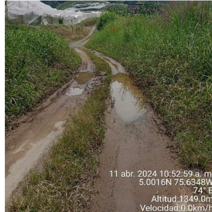
Fotografía 4-2. Encharcamiento superficial (Q Palmichal).
