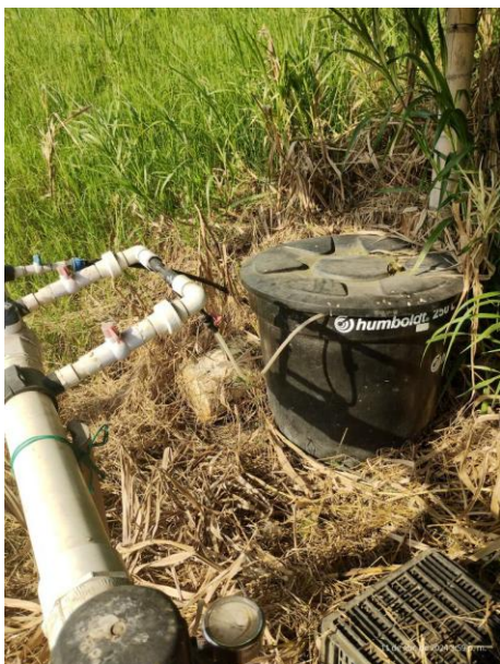
Fotografía 5-12 Sistema de bombeo de agua
