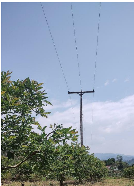
Fotografía 5-10 Línea eléctrica de baja tensión
