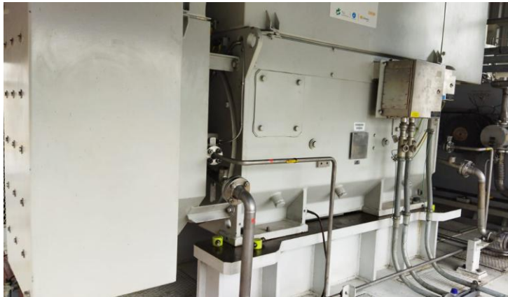
Ilustración 2. Generador Eléctrico Marca ABB.
