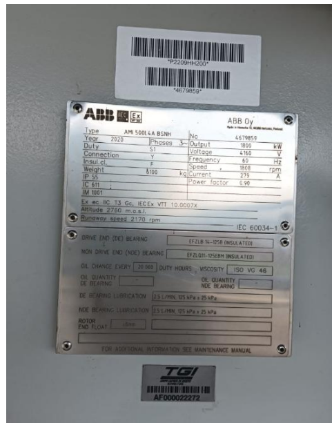
Ilustración 3. Datos de Placa del Generador.
