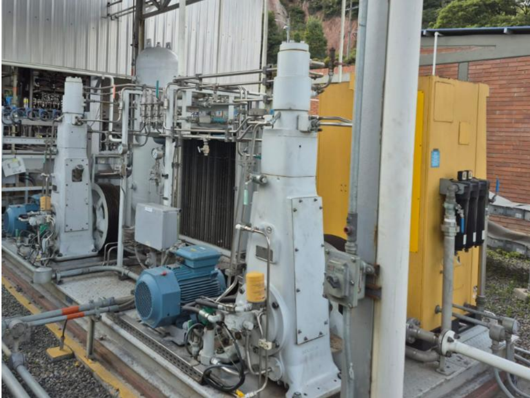
Ilustración 2. Foto General Skid de Generación de Nitrógeno.
